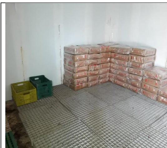
Dia 31/8/2017 – prédio do Dnocs: ausência de controle da validade dos produtos armazenados na câmara fria.
