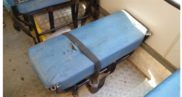
Foto 22: Veículo de placa PGG 3373: Assento deteriorado, com encosto retirado e peça de metal exposta, oferecendo perigo de lesionar os estudantes em caso de colisões e manobras bruscas; Serra Talhada/PE, 31 de agosto de 2017.
